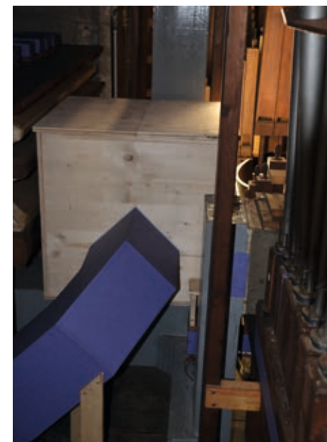
Der neue Motor im Schallschutzkasten
