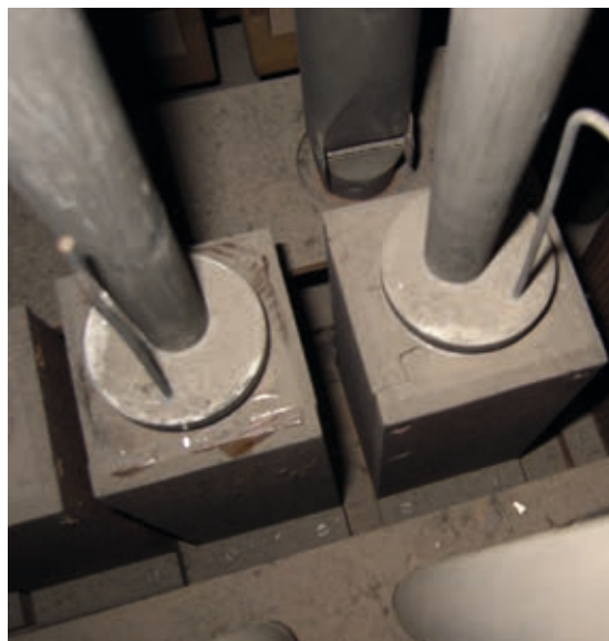
Gut ersichtlich ist hier ein gerissener Pfeifenstiefel und die starke Verschmutzung
