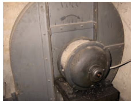
Der marode Gebläsemotor: fehlende Schmierung führte zum Lagerschaden
